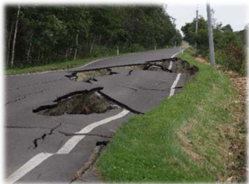
写真 道路の被害状況
