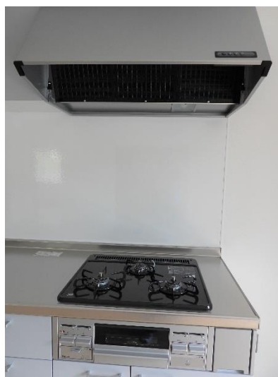
ガスコンロとレンジフード
