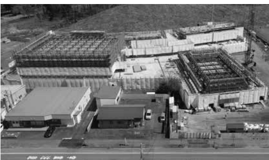
令和4（2022）年5月10日現在の工事の様子 （間もなく屋根の工事が始まります）
