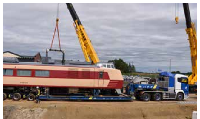
⑥夜が開け作業が進められる。「無事に作業が進んで欲しい」現場はきっと、そんな思いでいっぱいだったと思う。
