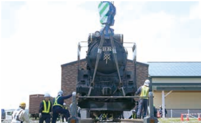
⑦大きなクレーンで吊り上げて、最後は人の目と感覚で作業が進む。寸分の狂いもなく移設が完了となった。
