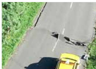
地震により隆起した道路。町内いたところで交通障害が発生した。
