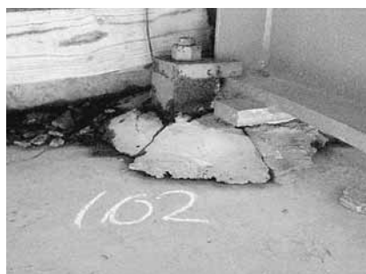
↑ 支承のモルタル欠損
